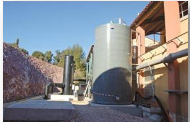
Nouvelles installations à la STEP d'Agay ©CAFSR
