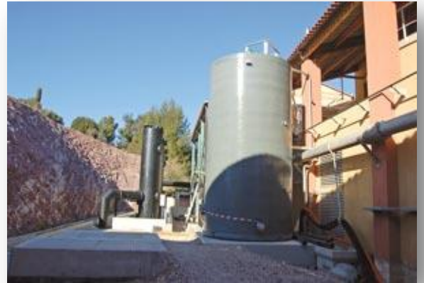
Nouvelles installations à la STEP d'Agay @CAFSR
