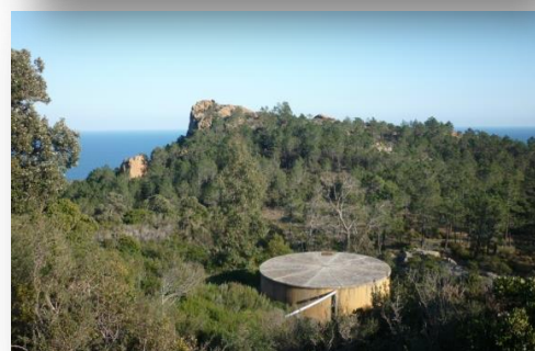
Ouvrages DFCI sur le site : réseau de pistes, citerne d'eau, réserve d'eau
